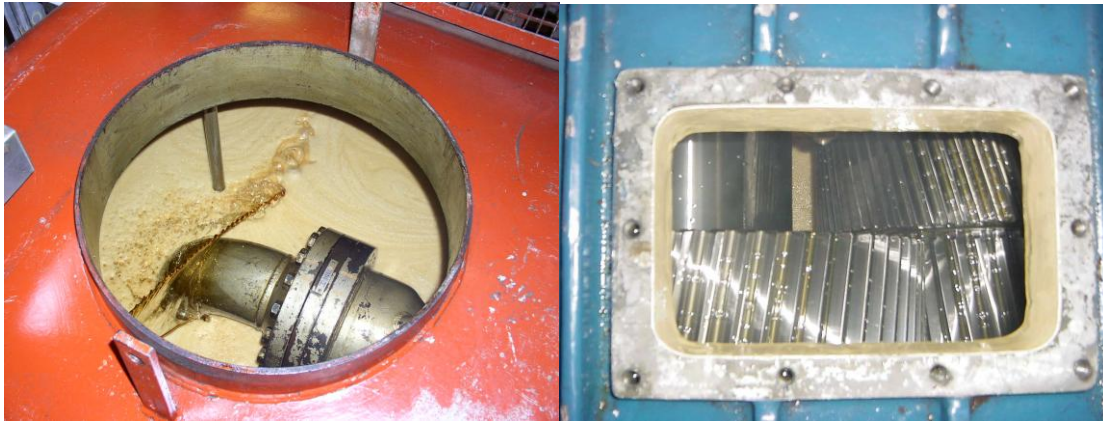
Espuma en un depósito de una turbina de vapor
