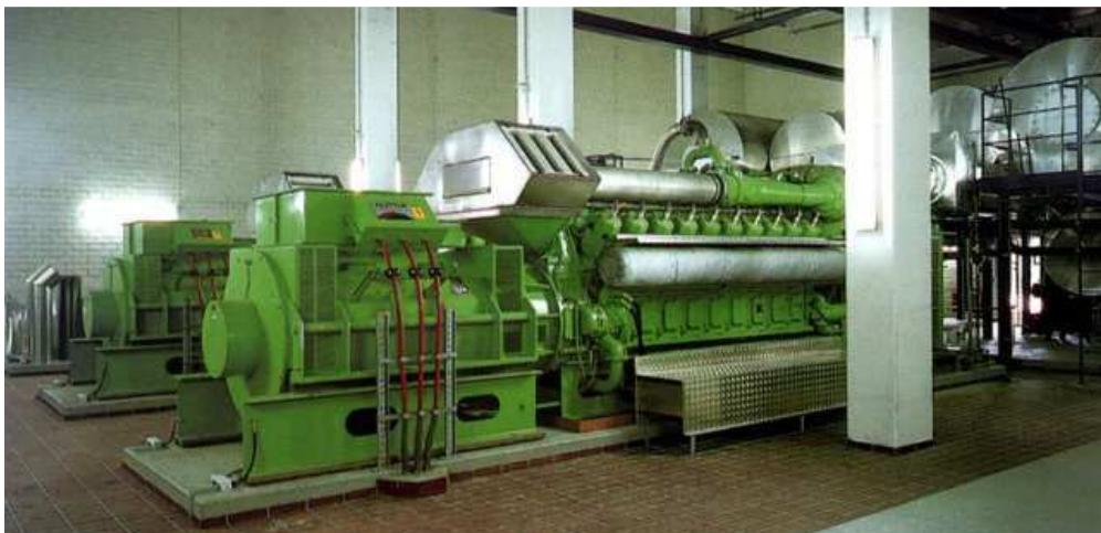
Figura 2. Motor de gas JENBACHER
