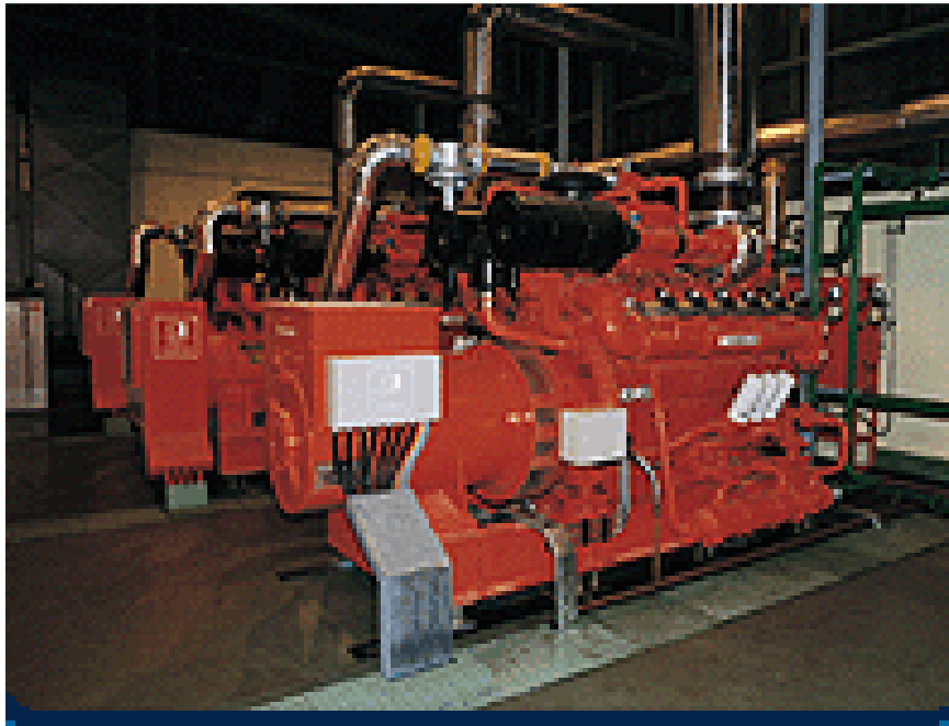
Figura 1. Motor de gas de vertedero de la marca GUASCOR
